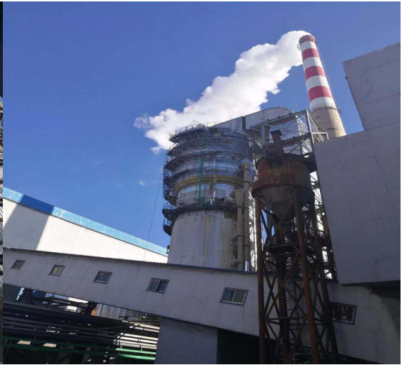
项目超净脱硫塔改造后
